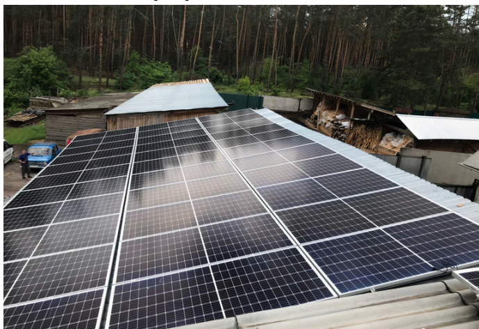
Черкаська обл. Станція потужністю 20 кВт. Деревопереробне підприємство
