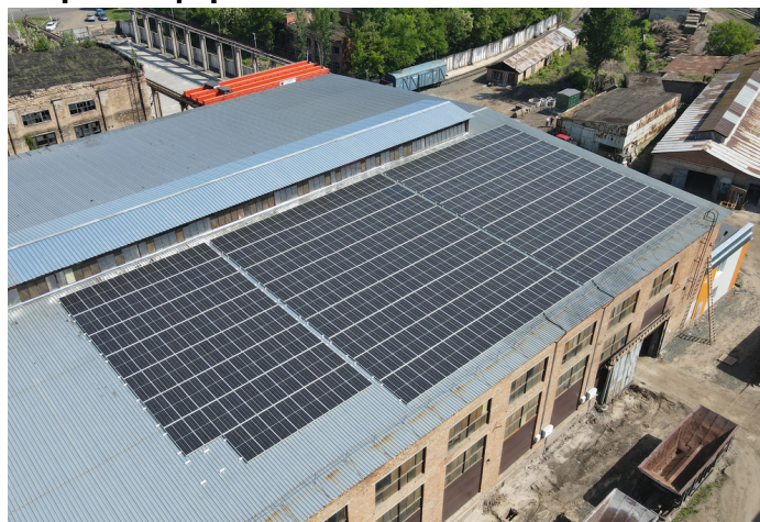
м. Сміла, станція потужністю 200 кВт. Вагоноремонтний завод
