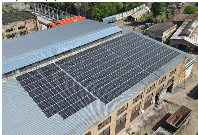
м. Сміла, станція потужністю 200 кВт. Вагоноремонтний завод
