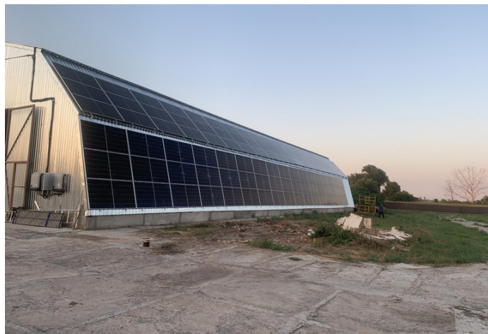
с.Нова Дмитрівка. Станція потужністю 81 кВт. Тваринна ферма
