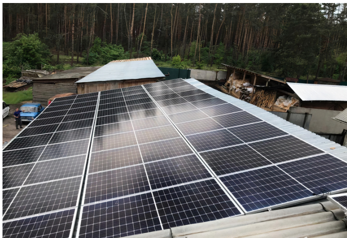
Черкаська обл. Станція потужністю 20 кВт. Деревопереробне підприємство
