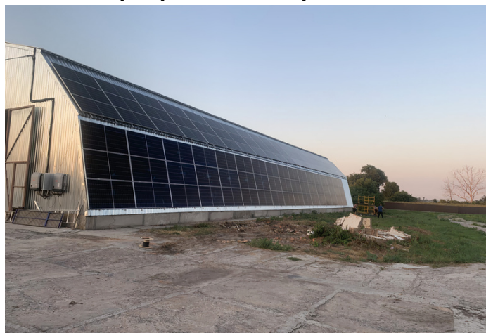
с.Нова Дмитрівка. Станція потужністю 81 кВт. Тваринна ферма
