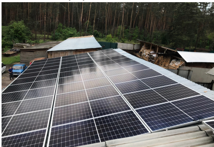
Черкаська обл. Станція потужністю 20 кВт. Деревопереробне підприємство
