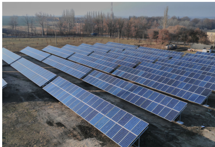
Запорізька обл. Станція потужністю 600 кВт Фермерське господарство
